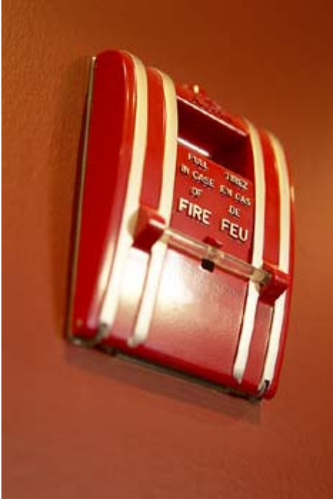
Fig. Fire Alarm
