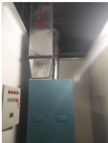
照片 7：粉尘收集回收装置
