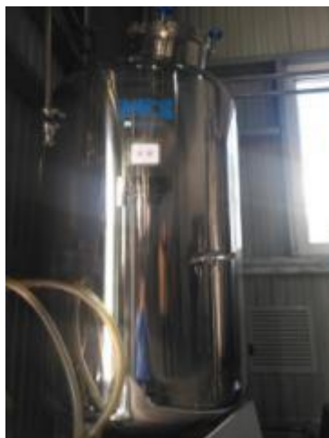
照片 9：乙醇收集储罐
