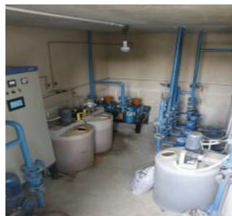
照片 4：污水处理站内部
