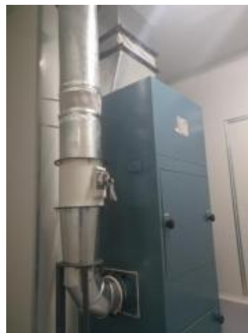
照片 6：粉尘收集回收装置
